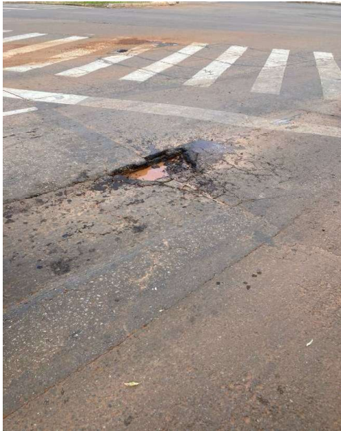
Patologia: Panela Local: Trecho 01 Coordenadas: -16.295512 -48.954883 Data: 06/03/2024
