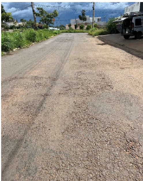
Patologia: Desgaste Local: Trecho 01 Coordenadas: -16.355434 -48.964852 Data: 06/03/2024
