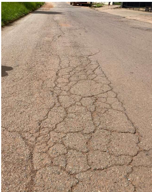
Patologia: Trincas Local: Trecho 03 Coordenadas: -16.355272 -48.964699 Data: 06/03/2024
