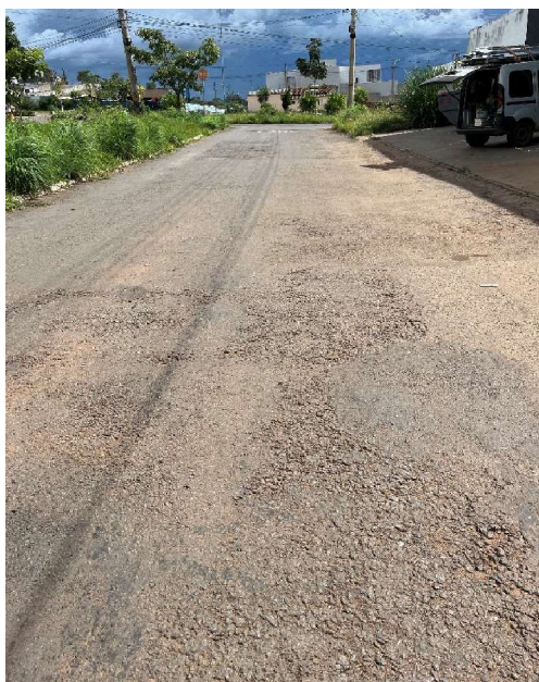
Patologia: Desgaste Local: Trecho 01 Coordenadas: -16.355434 -48.964852 Data: 06/03/2024
