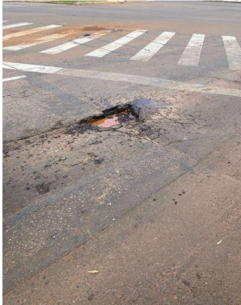
Patologia: Panela Local: Trecho 01 Coordenadas: -16.295512 -48.954883 Data: 06/03/2024
