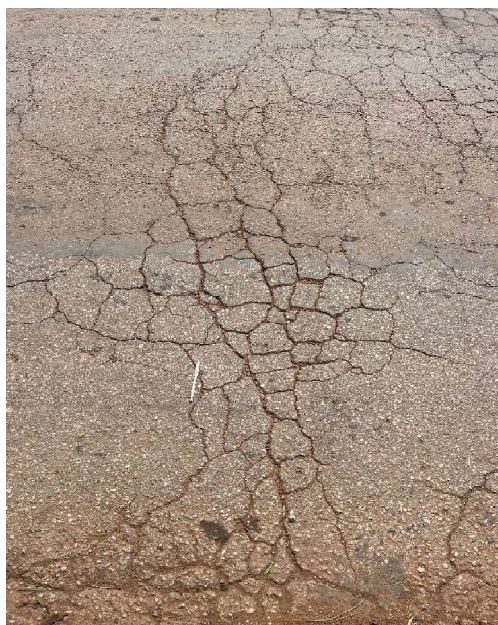
Patologia: Remendos Local: Trecho 03 Coordenadas: -16.356154 -48.961129 Data: 06/03/2024
