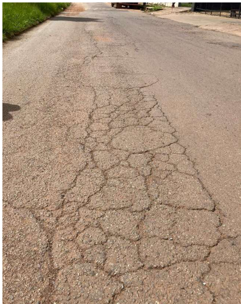
Patologia: Trincas Local: Trecho 03 Coordenadas: -16.355272 -48.964699 Data: 06/03/2024
