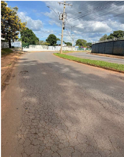
Patologia: Trincas e afundamentos Local: Trecho 01 Coordenadas: -16.295512 -48.954883 Data: 06/03/2024
