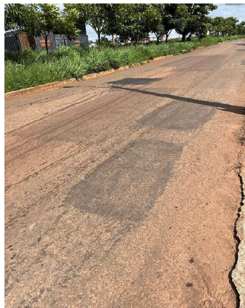
Patologia: Remendos Local: Trecho 02 Coordenadas: -16.355272 -48.964699 Data: 06/03/2024
