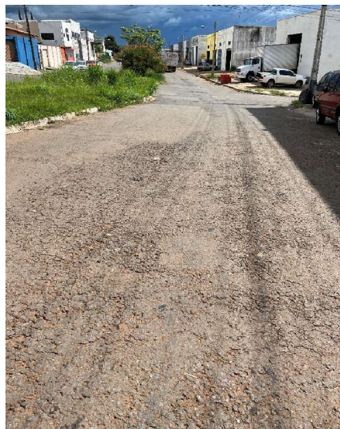
Patologia: Trincas e desgaste Local: Trecho 01 Coordenadas: -16.358136 -48.966985 Data: 06/03/2024
