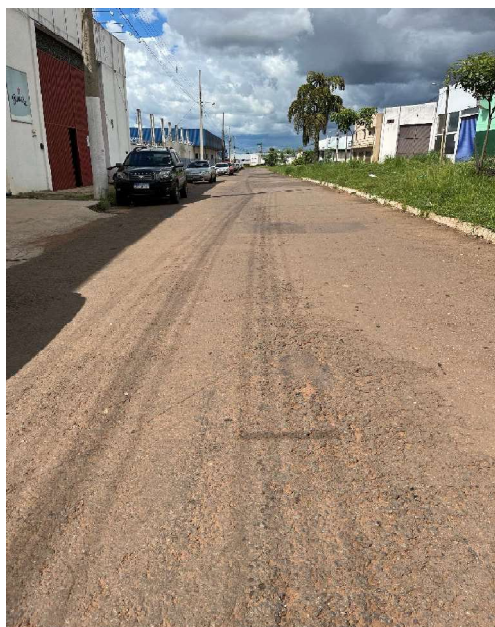
Patologia: Remendos Local: Trecho 01 Coordenadas: -16.358136 -48.966985 Data: 06/03/2024
