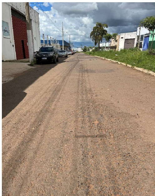
Patologia: Remendos Local: Trecho 01 Coordenadas: -16.358136 -48.966985 Data: 06/03/2024
