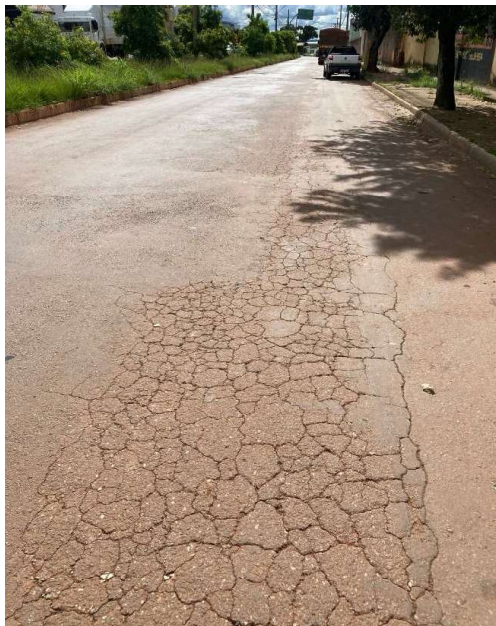
Patologia: Trincas Local: Trecho 01 Coordenadas: -16.355434 -48.964852 Data: 06/03/2024
