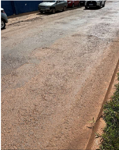
Patologia: Remendo e desgaste Local: Trecho 03 Coordenadas: -16.355272 -48.964699 Data: 06/03/2024
