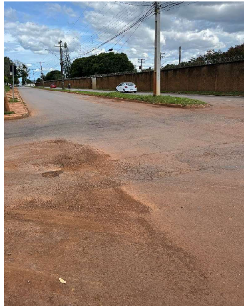
Patologia: Panela e remendo Local: Trecho 01 Coordenadas: -16.297707 -48.946671 Data: 06/03/2024
