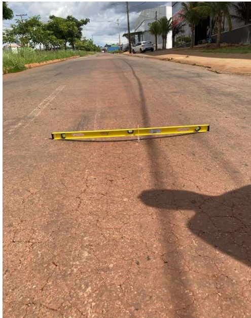
Patologia: Trincas e afundamentos Local: Trecho 02 Coordenadas: -16.344228 -48.967639 Data: 06/03/2024
