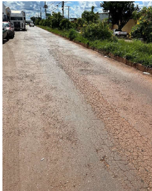
Patologia: Trincas e afundamentos Local: Trecho 03 Coordenadas: -16.356154 -48.961129 Data: 06/03/2024
