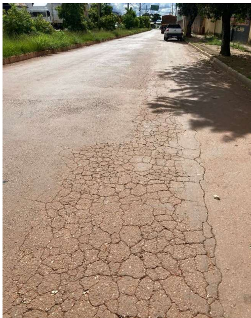
Patologia: Trincas Local: Trecho 01 Coordenadas: -16.355434 -48.964852 Data: 06/03/2024
