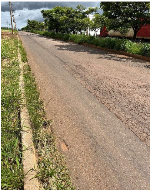
Patologia: Remendos e trincas Local: Trecho 02 Coordenadas: -16.344228 -48.967639 Data: 06/03/2024
