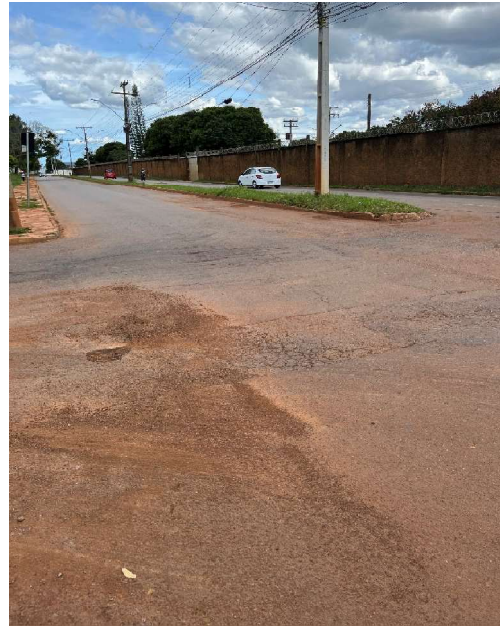
Patologia: Panela e remendo Local: Trecho 01 Coordenadas: -16.297707 -48.946671 Data: 06/03/2024
