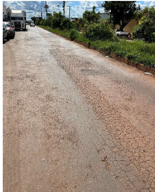
Patologia: Trincas e afundamentos Local: Trecho 03 Coordenadas: -16.356154 -48.961129 Data: 06/03/2024
