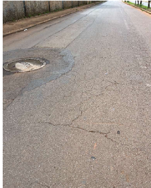
Patologia: Trincas e remendos Local: Trecho 01 Coordenadas: -16.297707 -48.946671 Data: 06/03/2024
