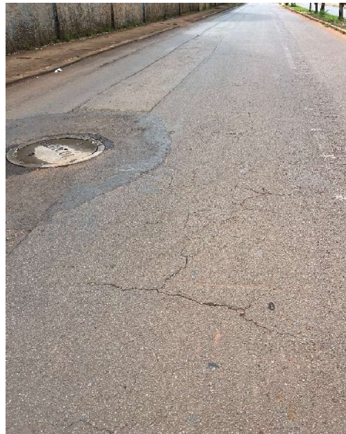
Patologia: Trincas e remendos Local: Trecho 01 Coordenadas: -16.297707 -48.946671 Data: 06/03/2024
