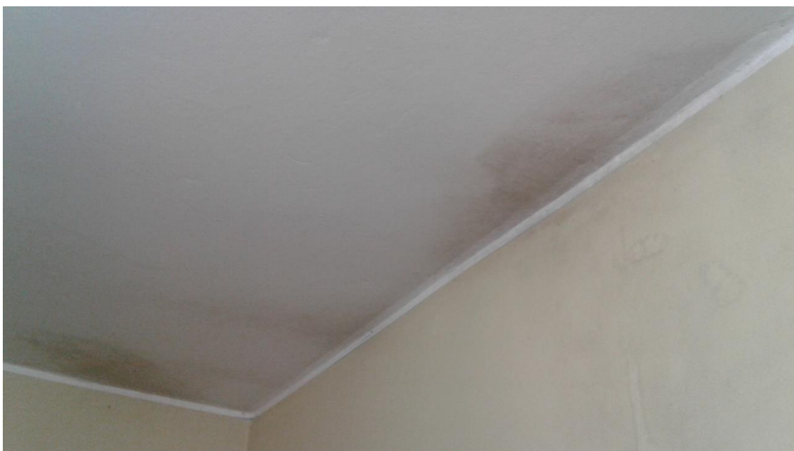
Figura 3: Infiltrações em teto e paredes
