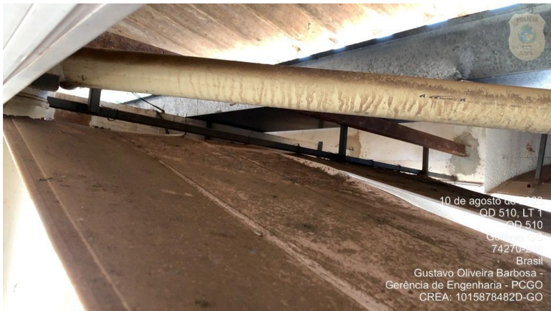
Descolamento do Forro
