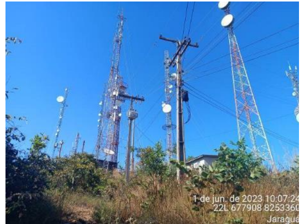
Praça de antenas
