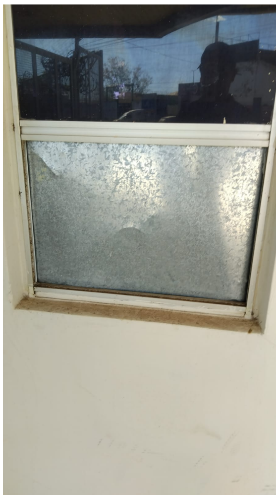
Foto 7: Vidro da janela da Guarita a ser trocado
