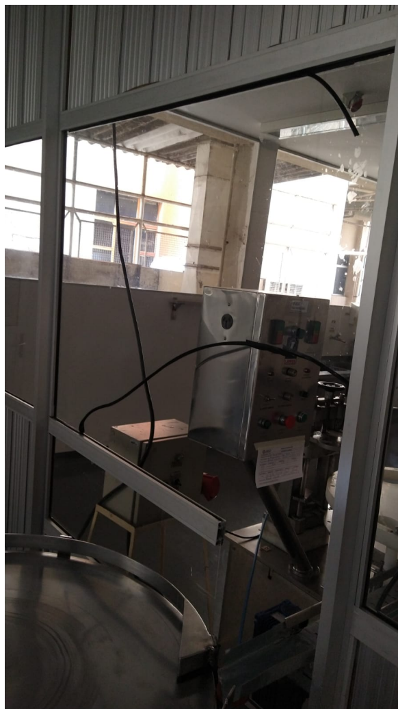
Foto 3: Vidro quebrado sala de envase de líquidos
