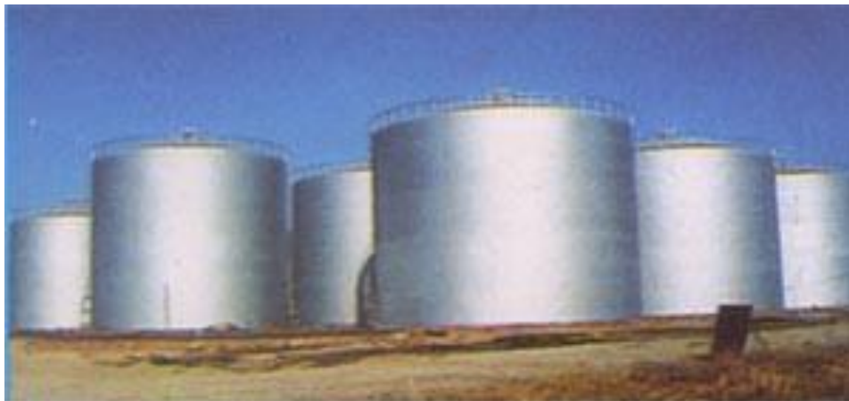
Figura 59: Exemplo de tanques de armazenagem.
