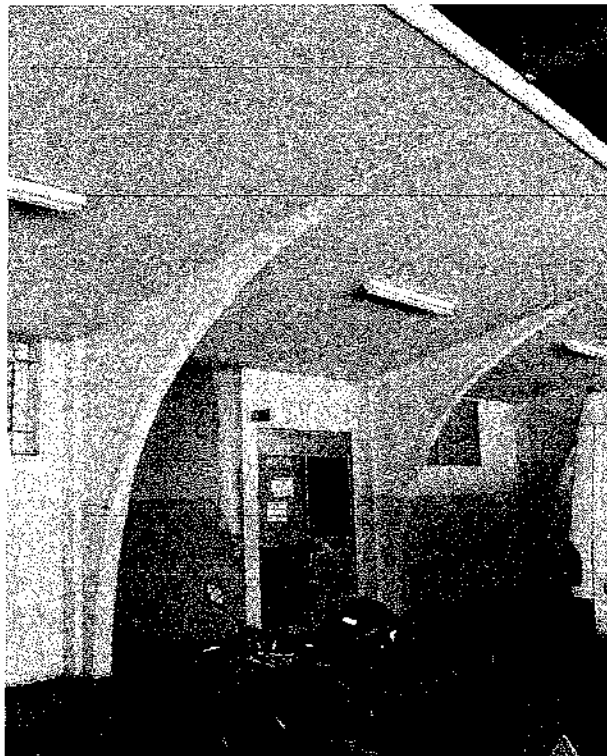
Foto 10: Detalhes da instalação
