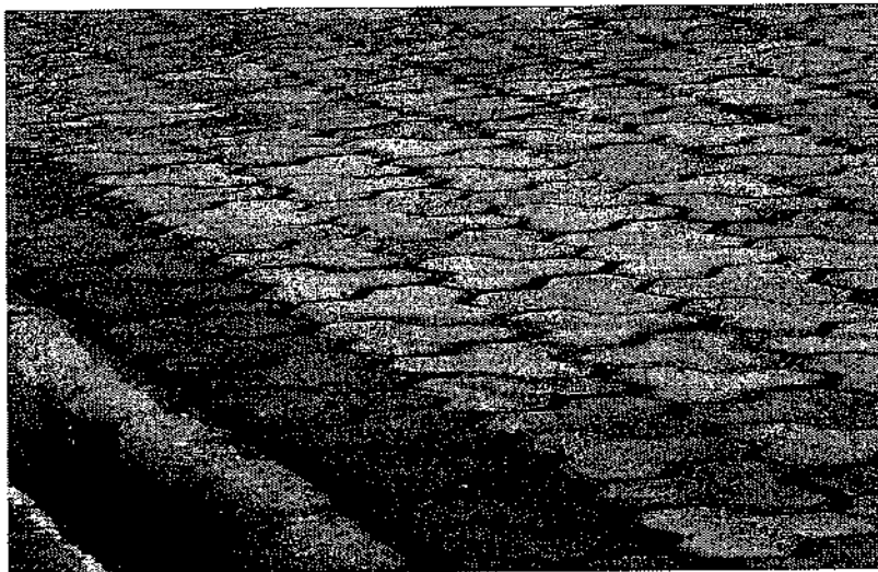
Foto 4: Detalhe do acabamento do bloquete junto ao meio fio, com preenchimento de argamassa
