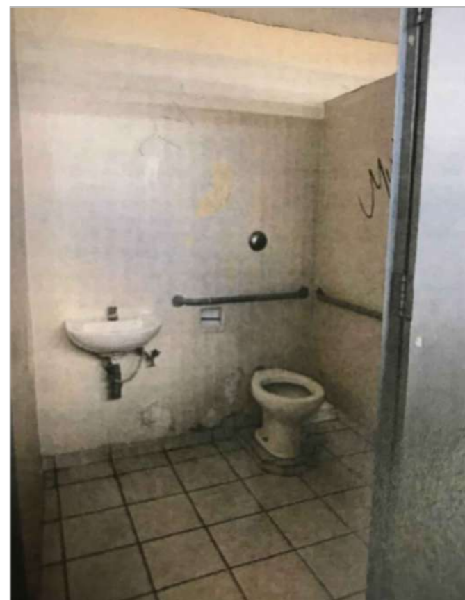
FOTO 3: BOX PNE NÃO ATENDE AS EXIGÊNCIAS DA NORMA DE ACESSIBILIDADE NBR 9050/2015.
