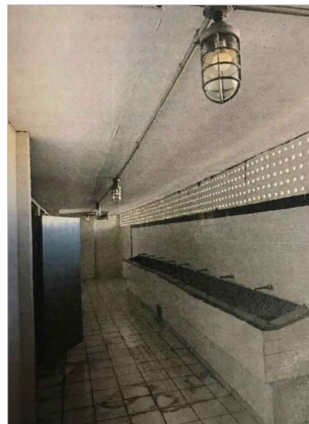
FOTO 1: SITUAÇÃO ATUAL DOS SANITÁRIOS.
