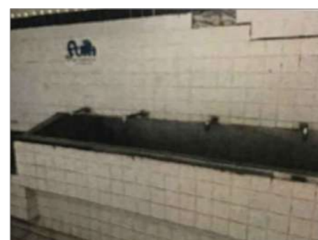
FOTO 3: REVESTIMENTOS CERÂMICOS DO SANITÁRIO MASCULINO, APRESENTAM DESLOCAMENTO E RACHADURAS.
