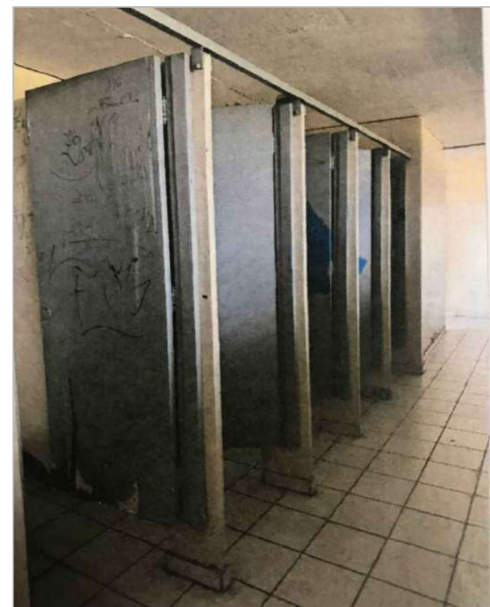
FOTO 2: DETALHE DO ESTADO DE CONSERVAÇÃO DAS PORTAS E DIVISÓRIAS DO BANHEIRO FEMININO.
