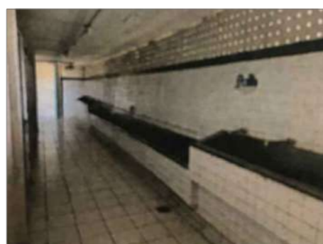
FOTO 1: SITUAÇÃO ATUAL DOS SANITÁRIOS MASCULINO.
