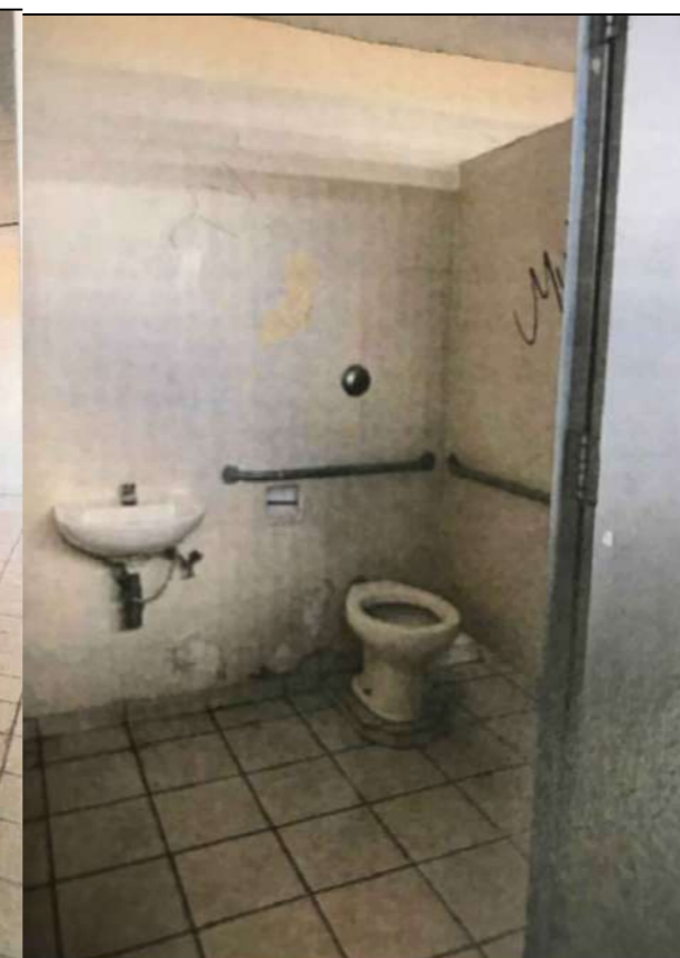
FOTO 3: BOX PNE NÃO ATENDE ÀS EXIGÊNCIAS DA NORMA DE SIBILIDADE NBR 9050/2015.
