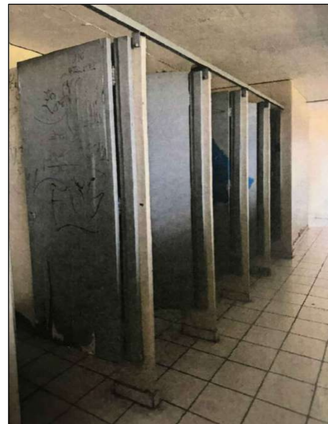
FOTO 2: DETALHE DO ESTADO DE CONSERVAÇÃO DAS PORTAS E DIVISÓRIAS DO BANHEIRO FEMININO.
