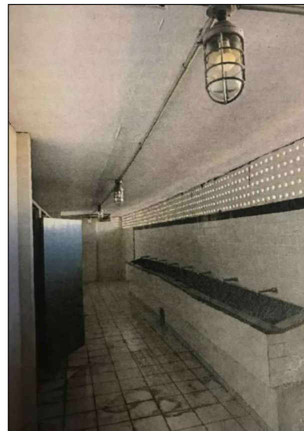
FOTO 1: SITUÇÃO ATUAL DOS SANITÁRIOS.
