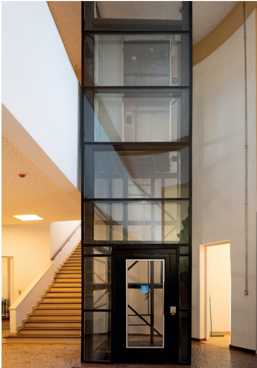
Plataforma elevatória amplia o acesso ao museu.
