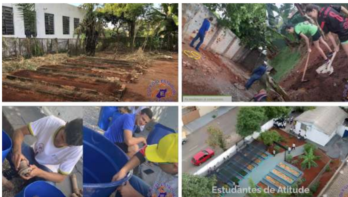
Imagem 5 - Registros do processo de construção da Sala Verde, realizada pelo Colégio Estadual Padre Pelágio.
