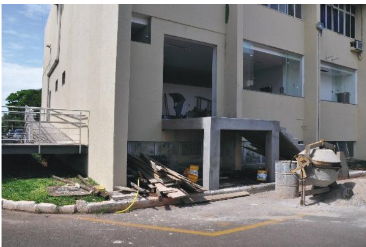
Central de Monitoramento
