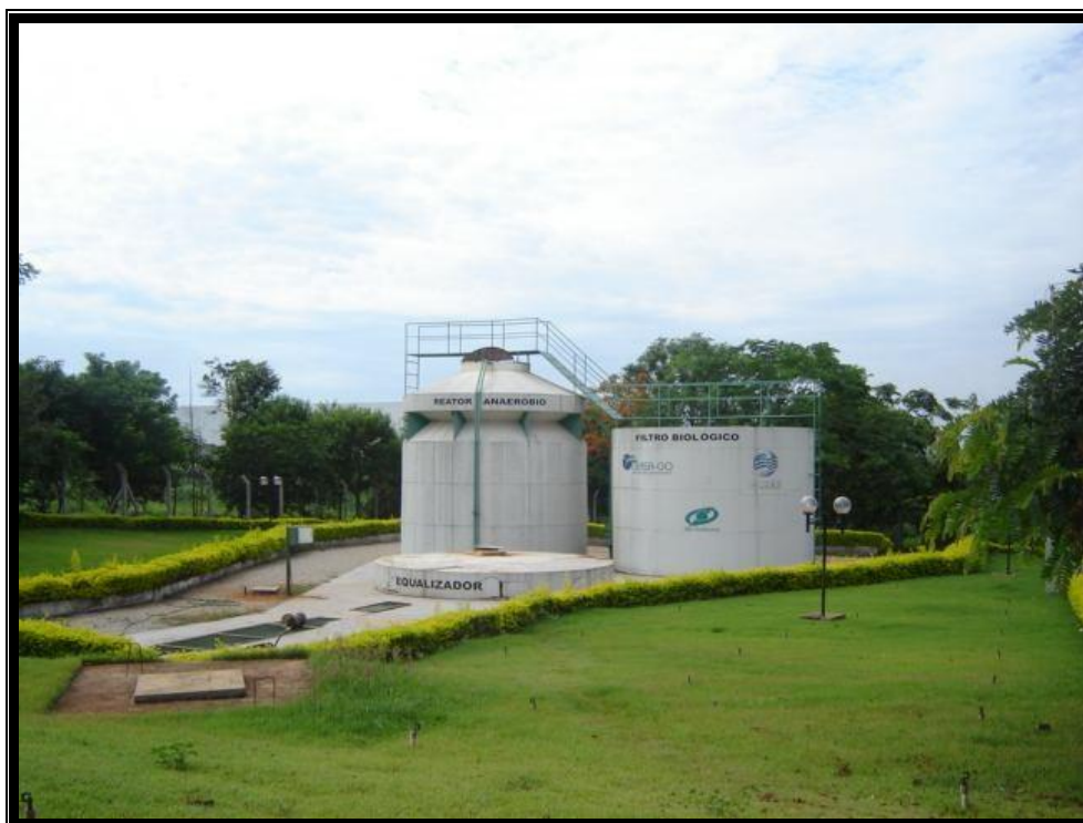
Figura 4 - Estação de Tratamento de Efluentes.
