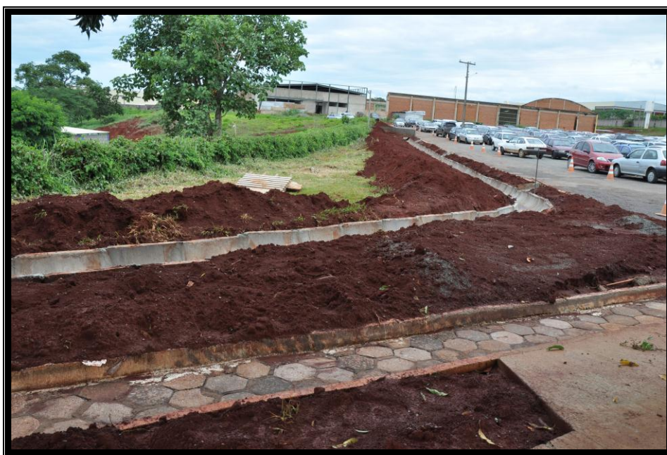
Figura 3 – Drenagens pluviais CEASA GO.
