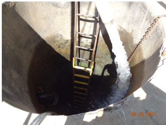
Foto 2 – Poço de sucção alimentado pela bomba submersa
