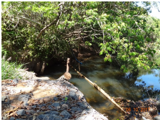
Foto 1 – Bomba submersa instalada
