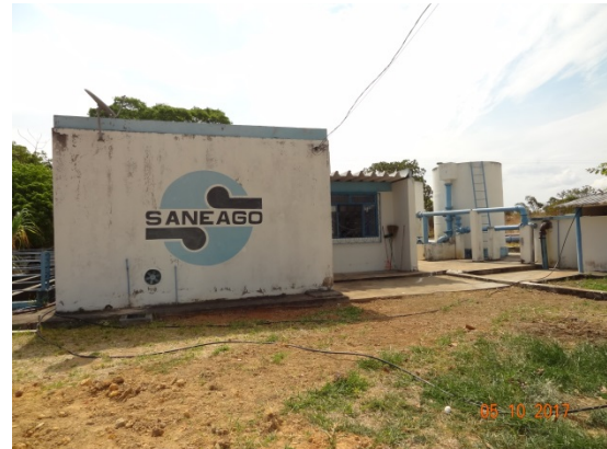
Foto 2 – Pintura desgastada nas edificações da ETA.
