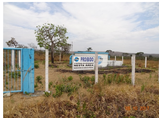
Foto 6 - RAP da cidade sem guarda-corpos na escada e topo.
