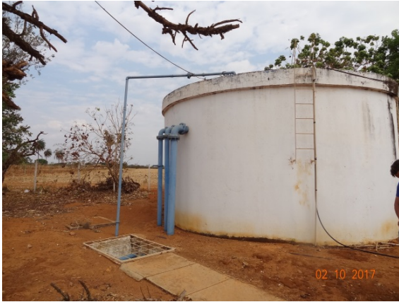
Foto 5 – RAP R1 com perda de revestimento, infiltrações e eflorescências.
