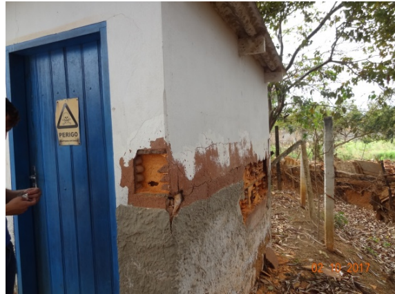
Foto 2 – Casa de cloração com perda de revestimento e pintura desgastada.
