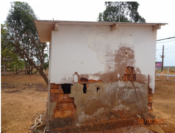
Foto 7 – RAP R 1 casa de cloração com perda de revestimento, pintura desgastada e buracos na parede.
