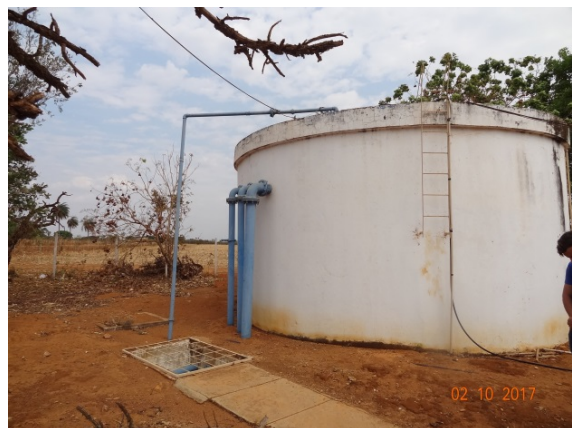
Foto 4 – RAP R1 com pintura desgastada.
