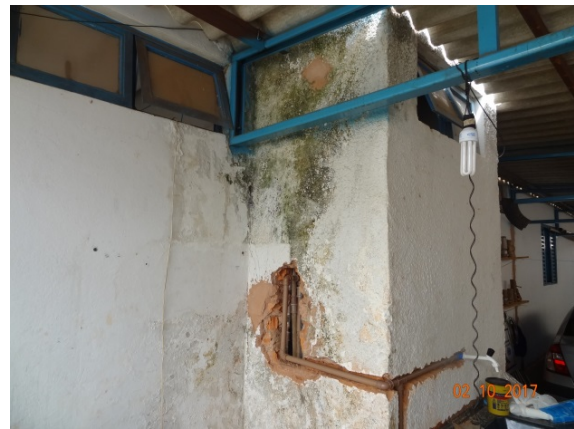
Foto 8 – Edificações do Distrito com presença de trincas, infiltrações e pintura desgastada (em reforma).
