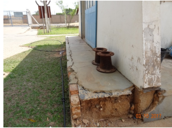
Foto 2 – Edificações da ETA com perda de revestimento.
