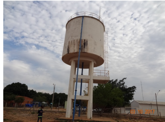
Foto 14 – REL Buenos Aires/Mãe Bela com infiltrações, perda de revestimento e pintura danificada.
