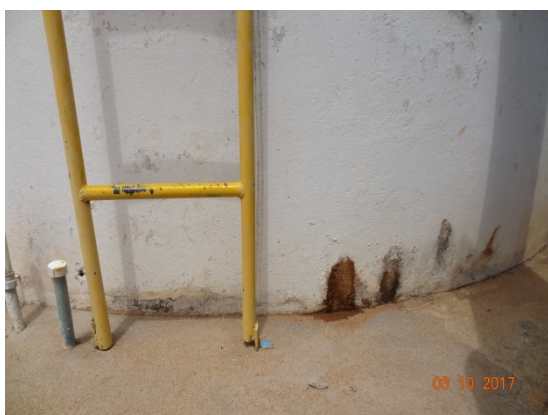
Foto 7 – Infiltrações no filtro russo.
