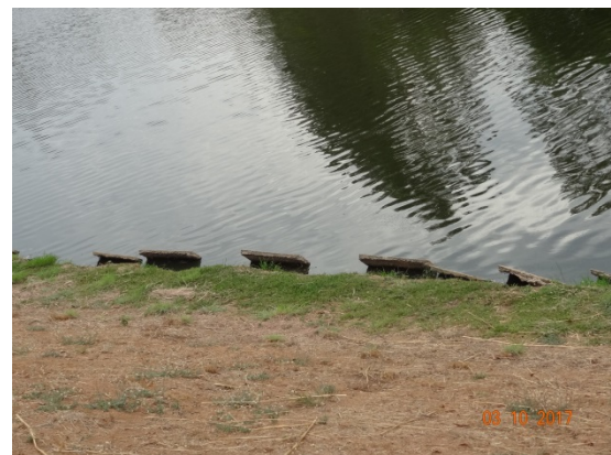
Foto 16 – Placas de proteção soltas, na borda da lagoa.
