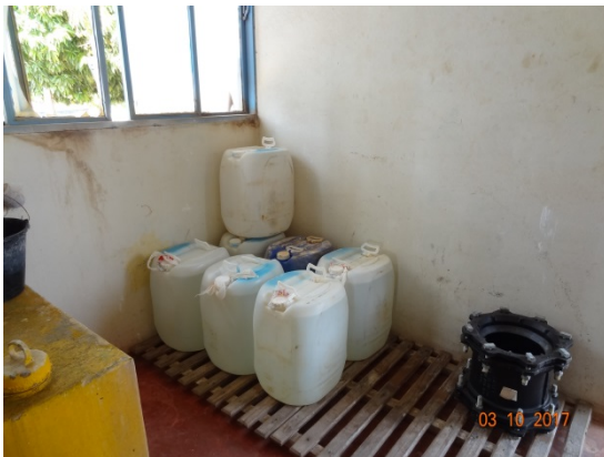
Foto 3 – Pintura desgastada parte interna da ETA.
