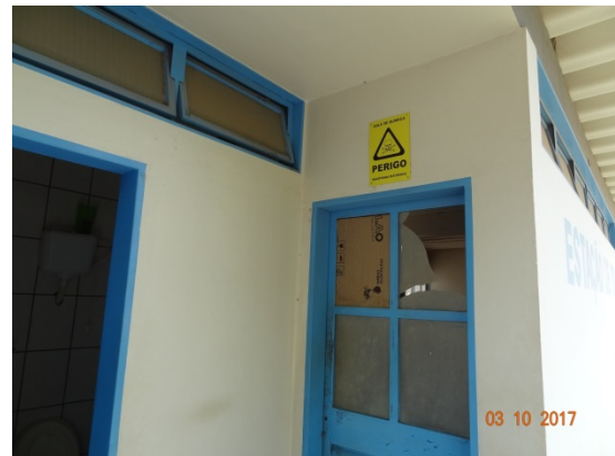
Foto 4 – Sala de química com porta de vidro quebrado.
