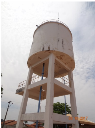
Foto 31 – REL da parte alta com infiltrações e pintura desgastada.
