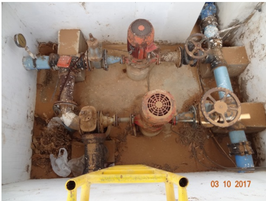
Foto 9 – EEAT da parte alta com perda de revestimento e pintura danificada.
