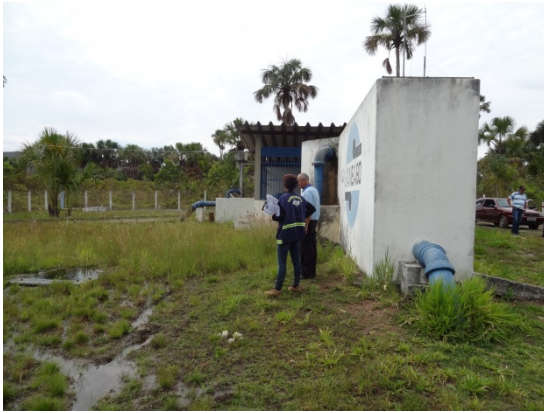
Foto 1 – Vazamento na caixa do extravasor da captação.
