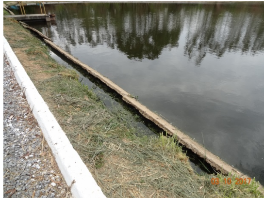
Foto 67 – Placas de proteção soltas, na borda da lagoa.
