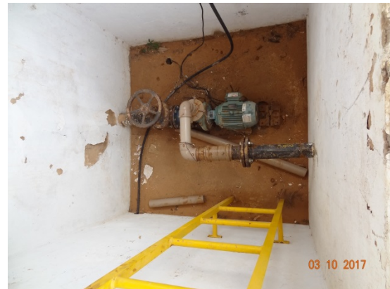
Foto 10 – EEAT Buenos Aires/Mãe Bela com perda de revestimento e pintura danificada.
