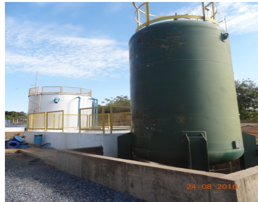
Foto 2 – RHO instalado, mas não em funcionamento.
