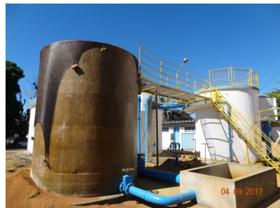
Foto 2 – ETA de Campinorte
