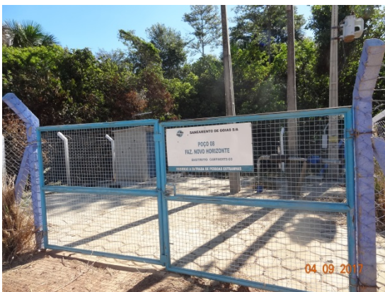
Foto 1 – Poço – 08 Faz. Novo Horizonte
