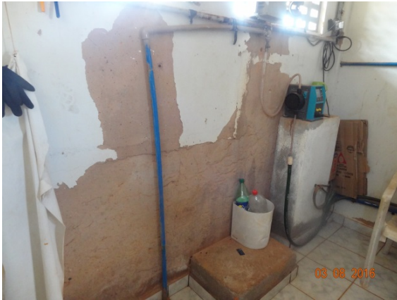
Foto 5 – Perda de revestimento na sala de cloração Jd. das Paineiras
