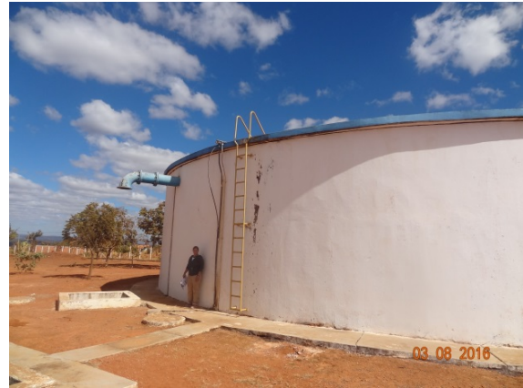
Foto 6 –RAP Itapuã II sem guarda-corpos escada e cobertura
