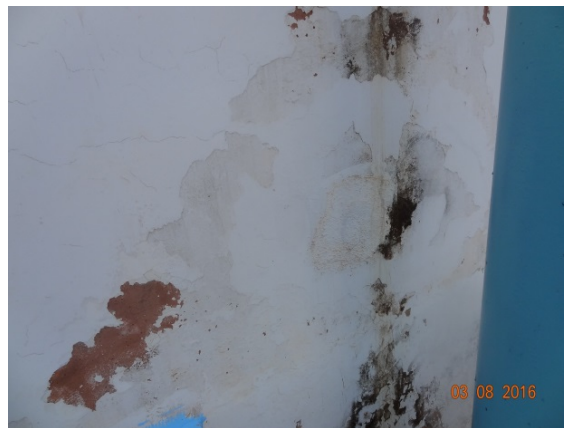
Foto 4 – Pintura desgastada no reservatório do escritório comercial
