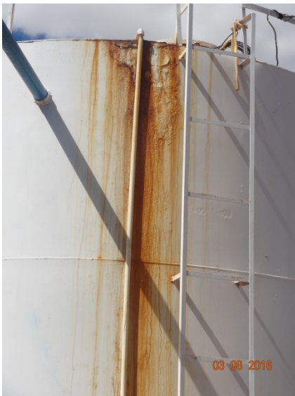
Foto 3 –RAP/caixa de reunião com corrosão no tanque e estrutura
