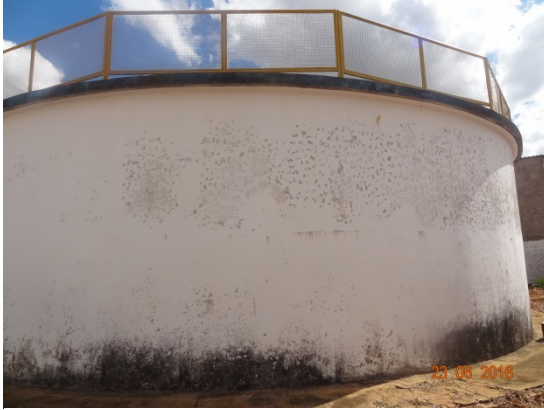
Foto 3 – RAP do escritório com pintura desgastada.
