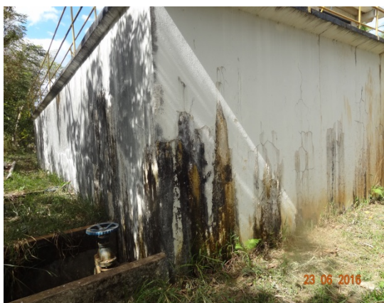
Foto 1 – ETA com infiltrações, eflorescências
