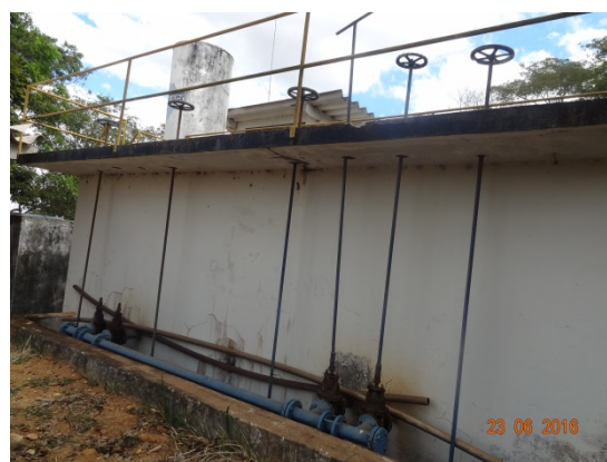
Foto 2 – ETA com pintura desgastada.
