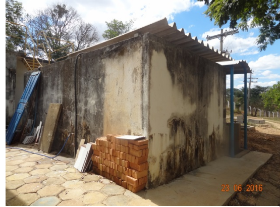
Foto 4 – Tanque de contato com infiltrações e pintura desgastada.
