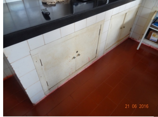
Foto 2 – Armários em mal estado de conservação
