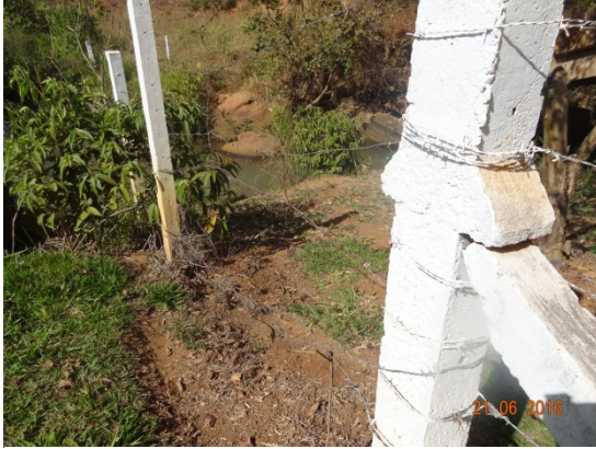
Foto 1 – Cerca de proteção danificada na captação
