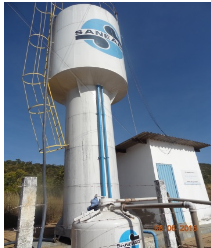
Foto 3 – REL com pintura recuperada.
