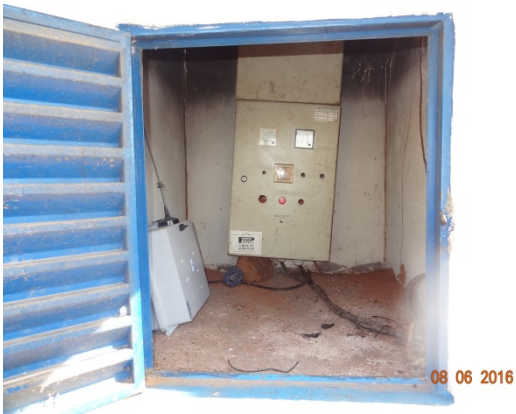
Foto 3 – Quadro de comando fixado.
