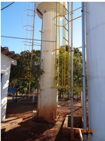
Foto 3 – REL antigo e danificado
