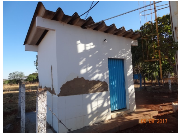
Foto 6 – Abrigo de cloração com perda de revestimento.
