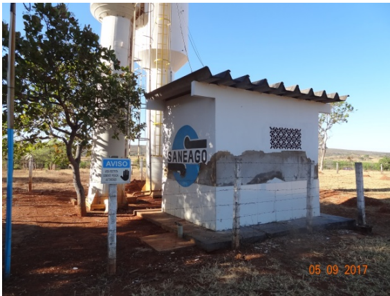
Foto 5 – Abrigo de cloração com perda de revestimento.
