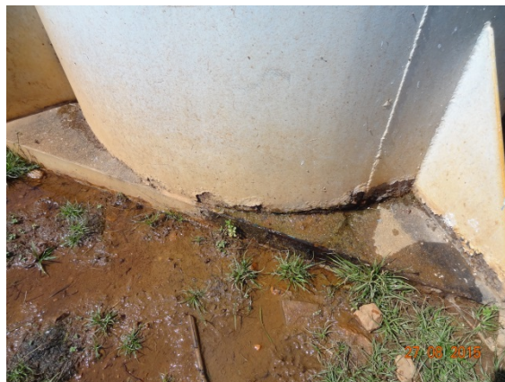
Foto 5 – Res. metálico com vazamento
