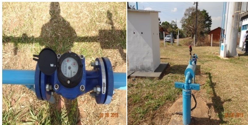
Foto 1 – Macromedidor instalado Foto 2 - Macromedidor
