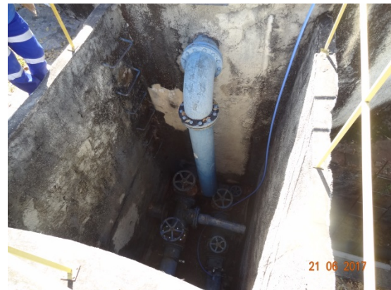
Foto 14 – RSE da ETA com escada de acesso ao poço de registro sem guarda-corpos.
