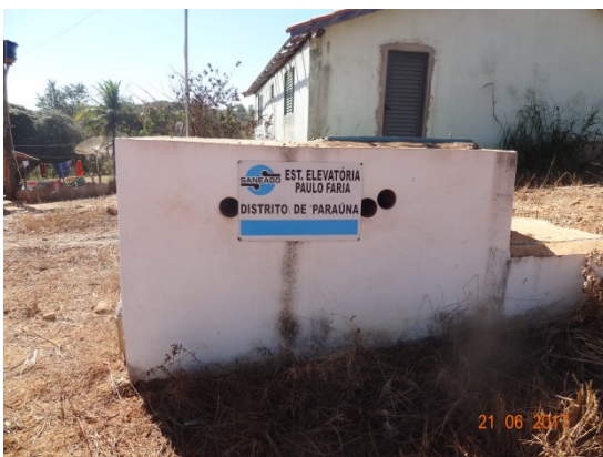
Foto 9 – EEAT/Booster centro (Paulo Farias) com área aberta sem urbanização e placa de aviso de risco.
