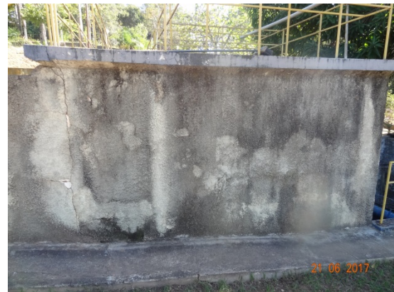
Foto 4 – Floculadores, decantação e filtração com rachaduras e pintura desgastada.
