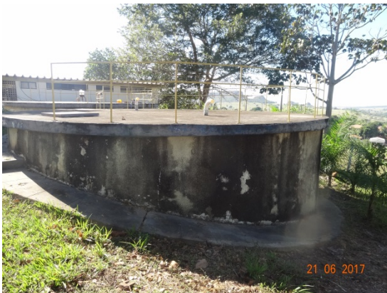
Foto 13 – RSE da ETA com pintura desgastada (dois RSE).
