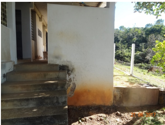
Foto 7 – Edificações com pintura desgastadas.
