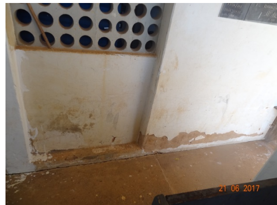
Foto 8 – Edificações com perda de revestimento.
