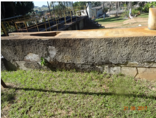
Foto 3 – Calha Parshal com trincas, infiltrações e eflorescências.
