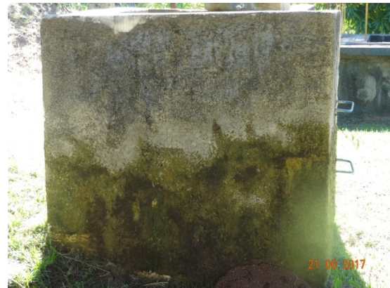
Foto 2 – Poço de água bruta com pintura danificada.
