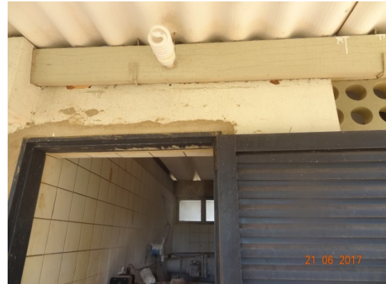
Foto 6 – Desinfecção falta placa de aviso de risco na sala do clorador.
