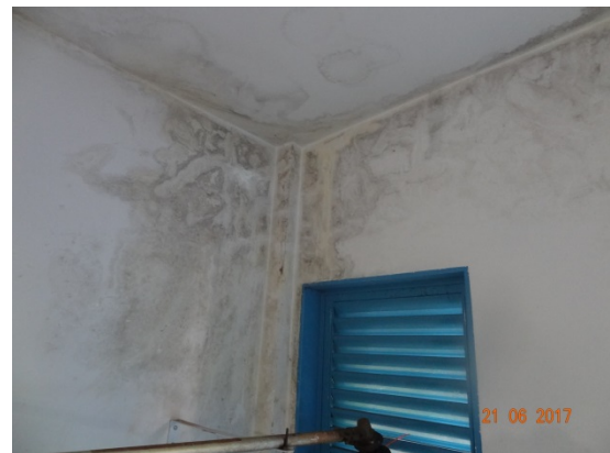
Foto 16 – Edificações do Distrito com infiltrações, calçada quebrada e pintura desgastada.
