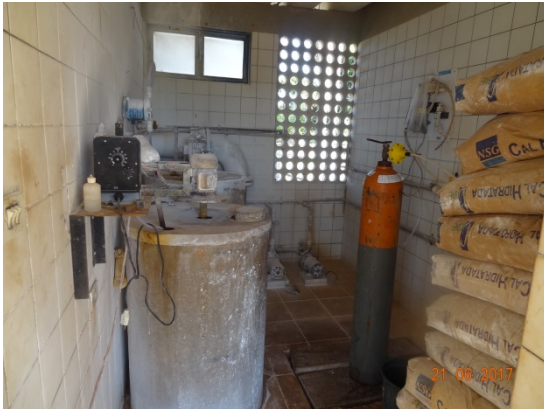
Foto 5 – Desinfecção falta manutenção e organização.
