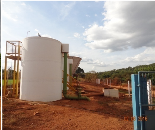
Foto 2 -ETA - Novos filtros e floco-decantadores instalados
