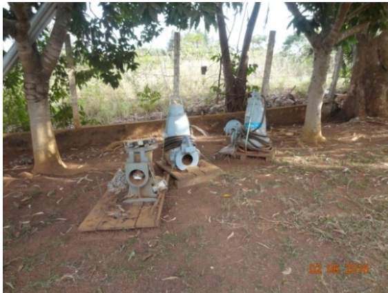
Foto 3 -Novas bombas da ETA
