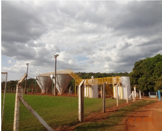
Foto 1 - ETA - Novos filtros e floco-decantadores instalados
