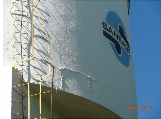
Foto 2 – REL da ETA com presença de infiltrações.
