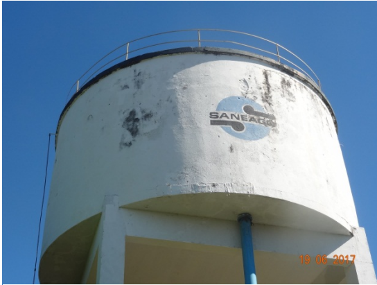
Foto 1 –REL da ETA com presença de infiltrações.
