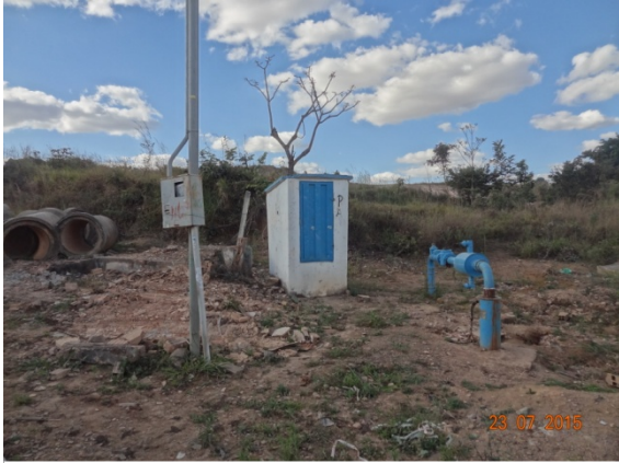
Foto 1 – Poço 05 (Parque Marajó – Ausência de cerca e identificação
