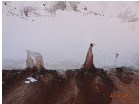
Foto 4 – Presença de infiltração no CR Cruzeiro do Sul
