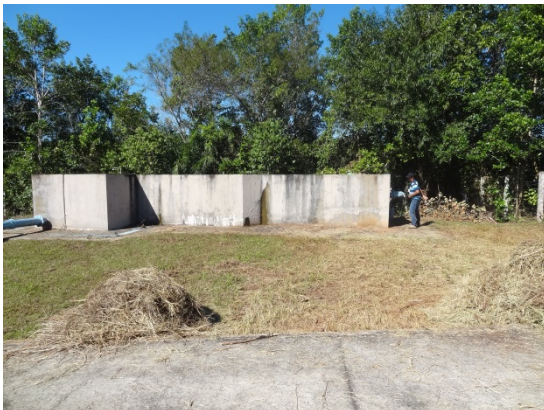
Foto 3 –RAP com pintura desgastada
