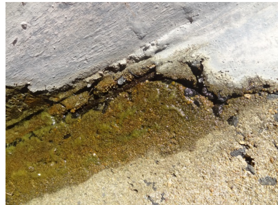
Foto 4 –RAP com infiltração e ferrugem exposta
