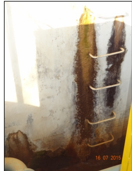
Foto 2 – ETA com infiltração
