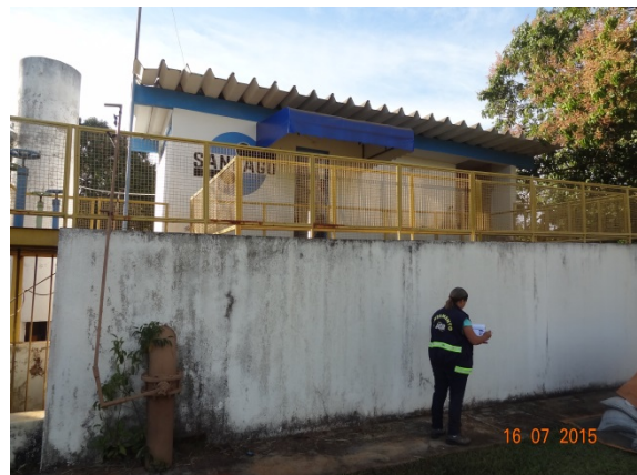
Foto 4 – ETA com pintura desgastada
