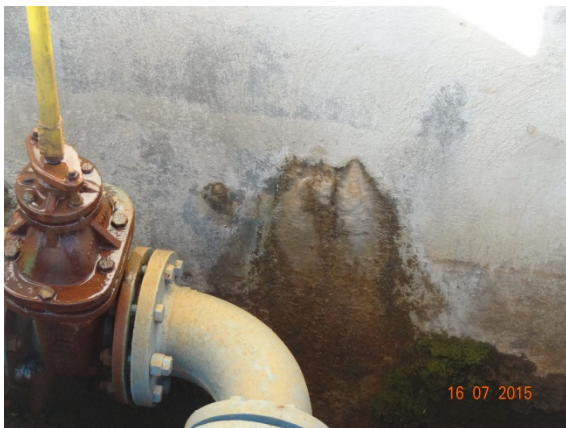
Foto 3 – ETA com eflorescência
