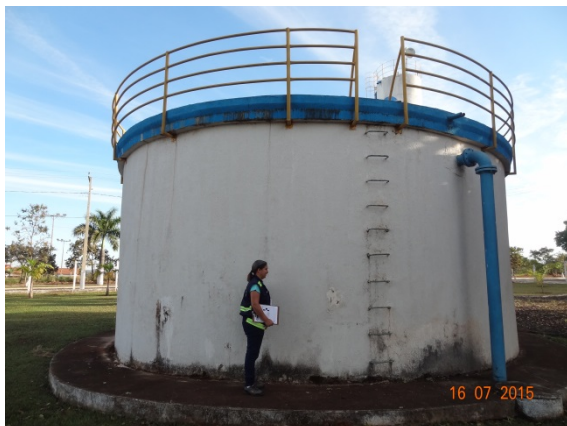
Foto 7 – Res. R1/ escada sem guarda-corpo
