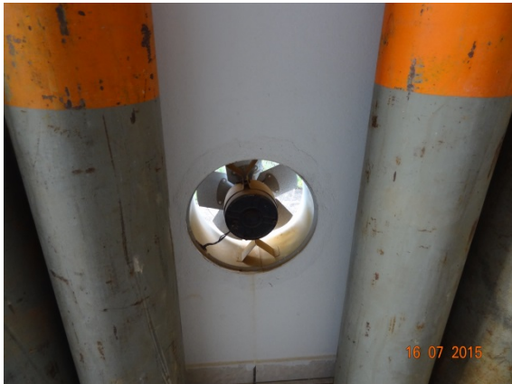
Foto 1 – Sala do clorador/exaustor danificado
