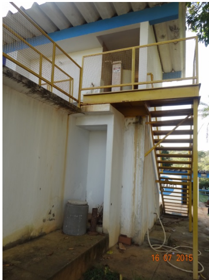
Foto 5 – ETA com perda de revestimento
