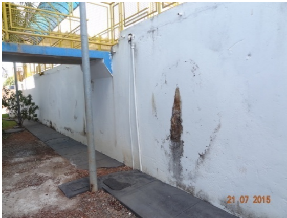
Foto 2 -Eflorescência na parede do decantador
