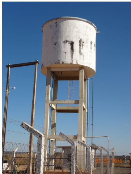
Foto 3 – Reservatório Bela Vista - Eflorescências / infiltrações
