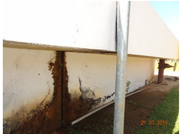
Foto 1 - Infiltração na junção dos dois módulos
