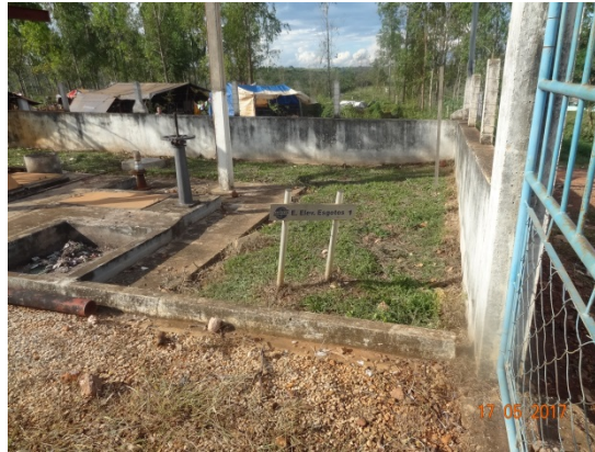
Foto 1 – EEE I (matadouro) com cerca danificada
