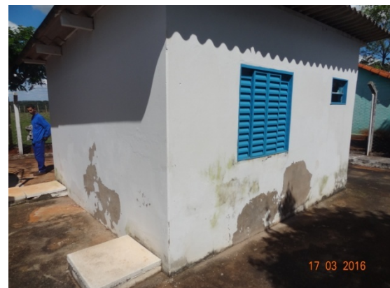
Foto 4 - Reservatório/sala do clorador
