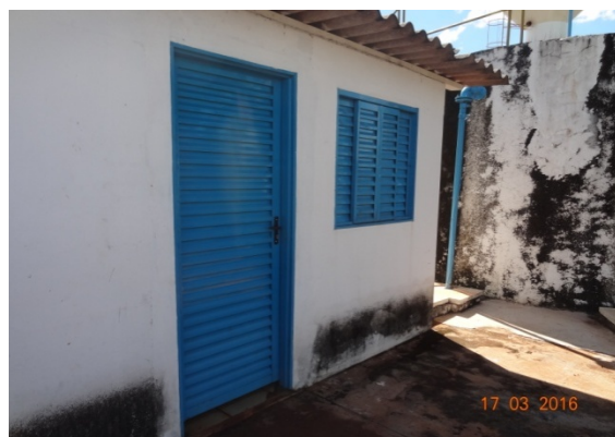
Foto 5 - Reservatório/sala do clorador - porta nova
