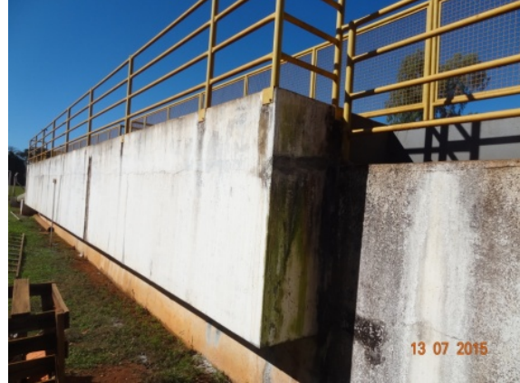
Foto 2 – ETA com pintura desgastada
