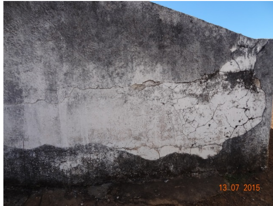
Foto 9 – Res. “B” com perda de revestimento
