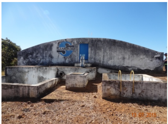
Foto 5 – Res. “B” com pintura desgastada
