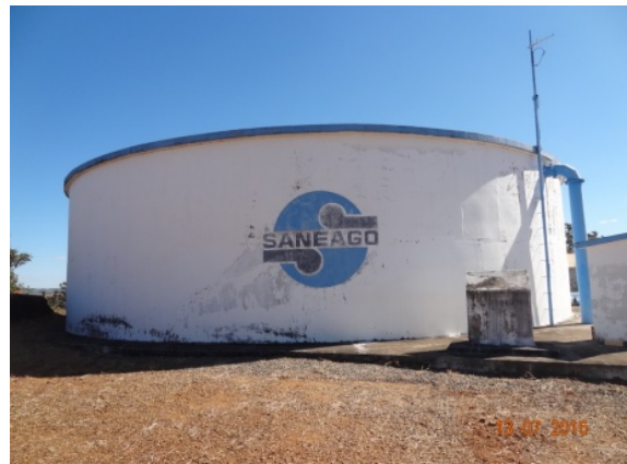
Foto 6 – Res. “A” com pintura desgastada
