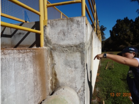
Foto 1 – ETA com infiltração
