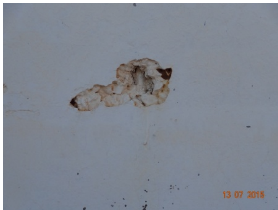
Foto 4 – Res. “A” com ferragem exposta
