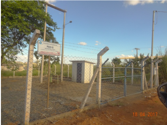
Foto 1 – Poço 02 - Setor Bela Vista identificado
