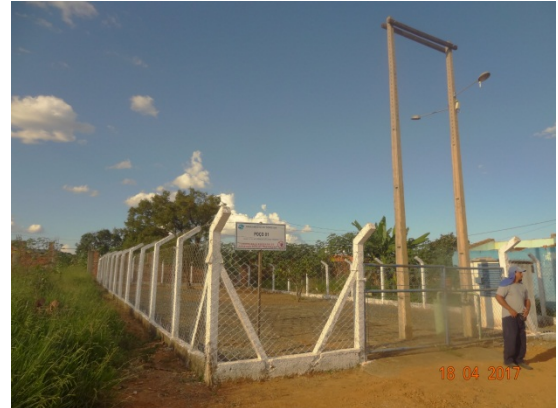
Foto 2 – Poço 01 - Setor Bela Vista identificado
