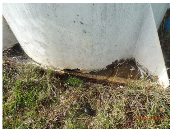
Foto 2 – Res. elevado com corrosão na base
