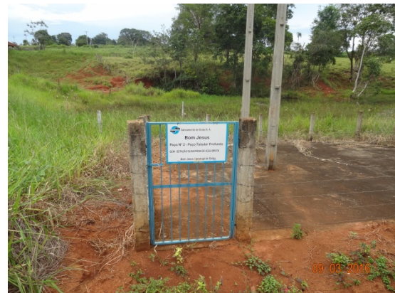
Foto 4 – Poço 02 com cerca de proteção e portão
