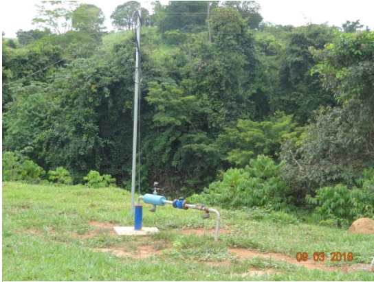
Foto 1 – Poço PGD 151 sem cerca de proteção e/ ou nortão
