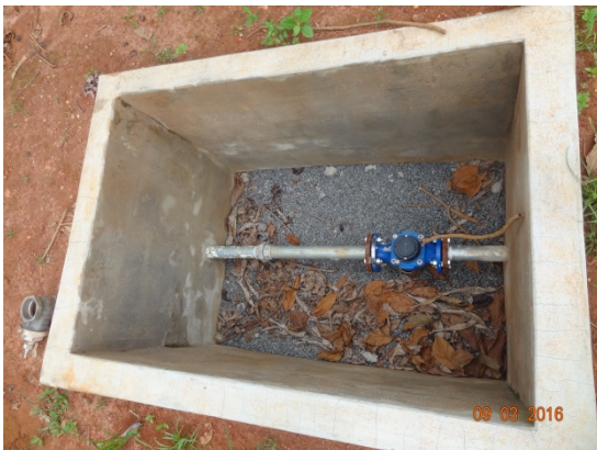
Foto 5 – Reservatório com macromedidor
