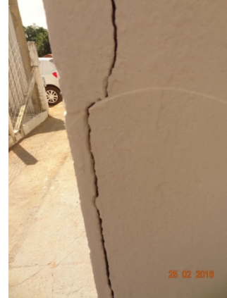
Foto 2 –Trinca e possível corrosão
