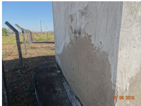
Foto 2 – Casa do clorador com pintura desgastada
