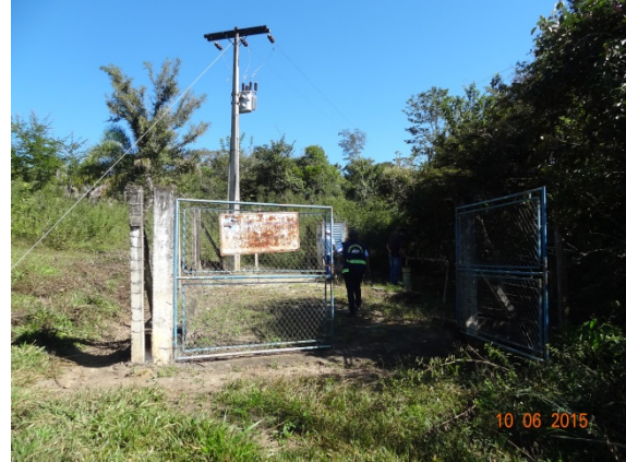
Foto 2 – Poço com placa sem pintura
