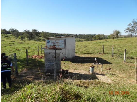
Foto 1 - Poço com placa e casa do quadro de comando sem pintura
