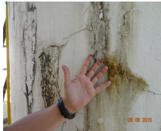
Foto 2 – Poço de contato com infiltração
