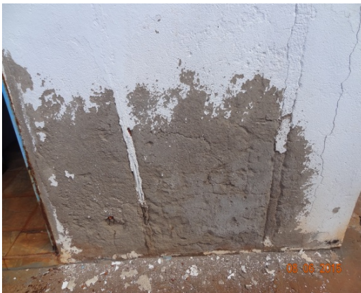
Foto 3 – Perda de revestimento e pintura
