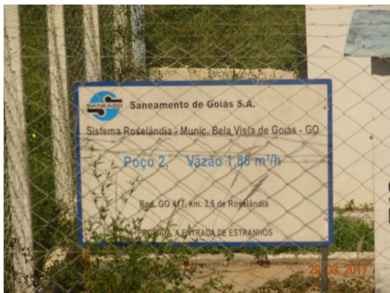
Foto 1 – Poço 2 com identificação
