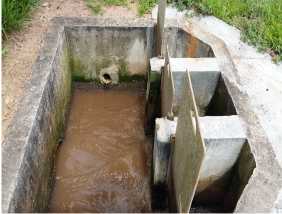
Foto 1 – Chegada do esgoto bruto
