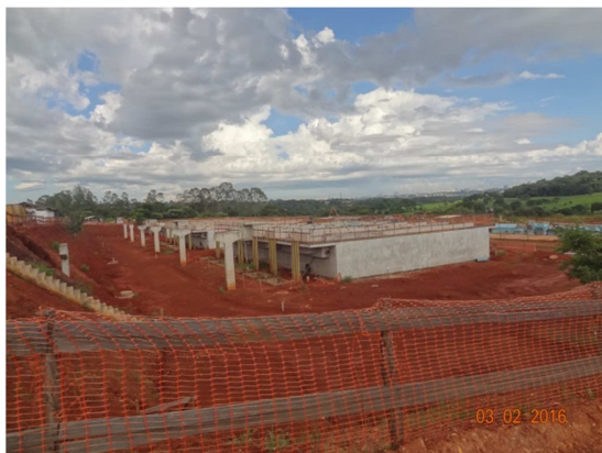
Foto 1 – Reatores ETE Santo Antônio (fevereiro)
