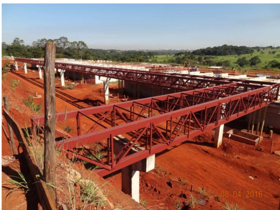
Foto 3 – ETE Santo Antônio (abril)
