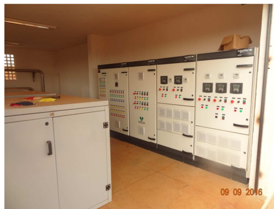
Foto 10 – Quadro de comando ETE Santo Antônio (setembro)
