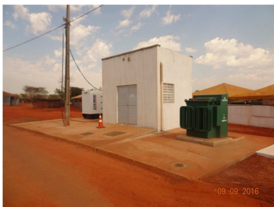
Foto 11 – Grupo Gerador ETE Santo Antônio (setembro)
