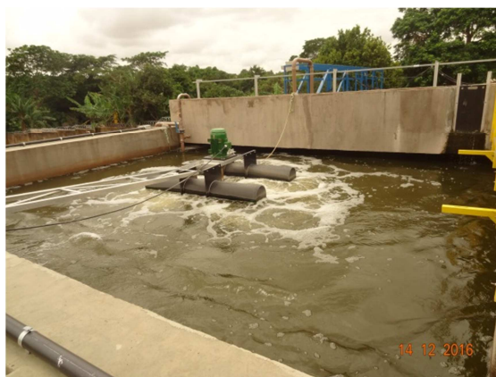
Foto 22: ETE Parque das Nações em operação (dezembro)
