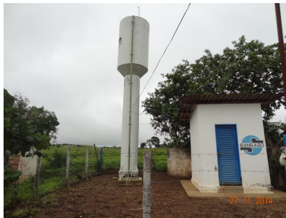
Foto 1 – Ausência de guarda-corpo
