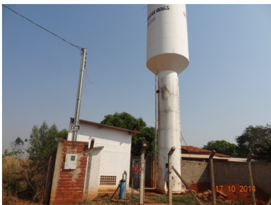
Foto 1 – Inexistência de identificação
