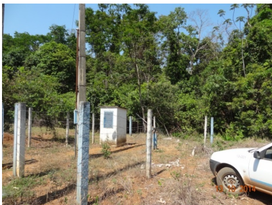
Foto 1 – Inexistência de identificação
